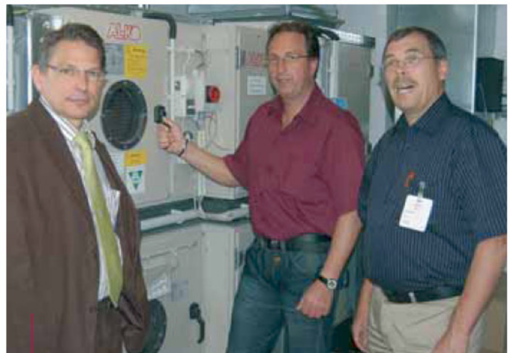
In der neuen Technikzentrale im Bau M / Brauweg 40. The energy system in building M / Brauweg 40.
