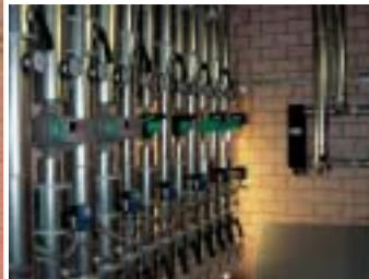
Der neue Heizungsverteiler ...
