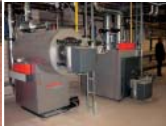
Der neue Heizkessel mit Brennwertechnik ...
