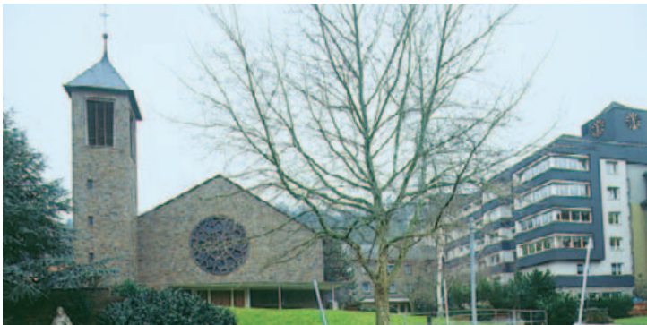
Kloster Kühr: Drei Öl-Heizkessel mit Leistungen von jeweils 800 kW wurden durch einen Vitocrossal 300 mit 895 kW und einen Vitoplex 300 mit 720 kW ersetzt.
