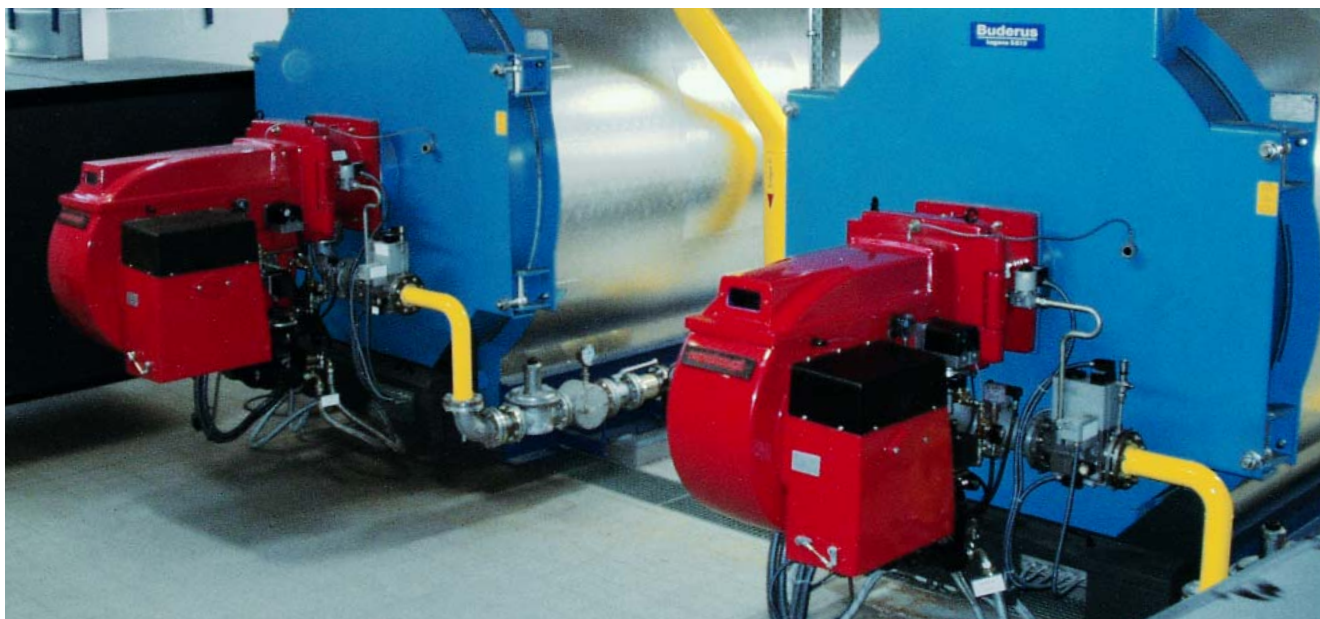
Jetzt arbeiten zwei Weishaupt-Zweistoffbrenner multiflam® mit digitalem Feuerungsmanagement an den neuen Buderus-Wärmeerzeugern im Heizwerk Mariahof der Stadtwerke Trier GmbH
