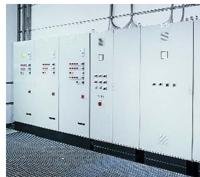
Weishaupt-Schaltanlage für die Regelung und Steuerung der neuen Heizzentrale
