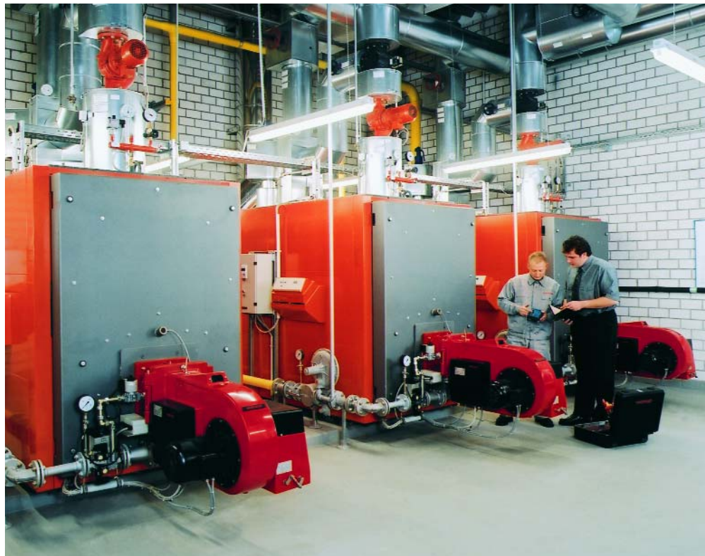
In der neuen Heizzentrale befeuern drei Weishaupt-Gasbrenner G40 mit digitalem Feuerungsmanager W-FM 100 die Niedertemperatur-Kessel Fabrikat Viessmann. An der Anlage: Servicetechniker Haiko Friede (links) und Technischer Verkäufer Nico Hendrich (rechts). Beide sind tätig in der Weishaupt-Niederlassung Leipzig
