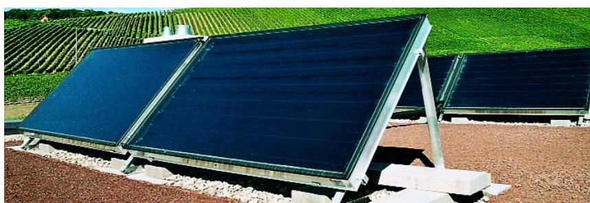
Vier Weishaupt-Solkollektoren in Flachdach-Ausführung versorgen das Weingut Hirn mit Wärme für Heizung und Warmwasserbereitung
