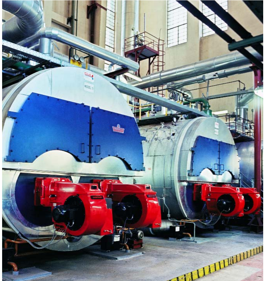
Zwei Heißwasser-Doppelflammrohr-Kessel arbeiten jetzt mit vier Weishaupt-Zweistoffbrennern RGL70 multiflam®, welche die strengen Emissionsvorgaben der GEW RheinEnergie erfüllen
