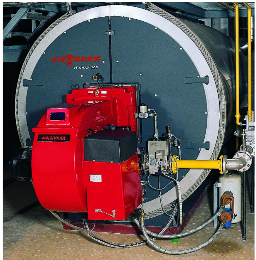
Ein modulierend arbeitender Weishaupt Zweistoffbrenner RGL70 liefert die Heiz- und Prozesswärme für das gesamte Unternehmen
