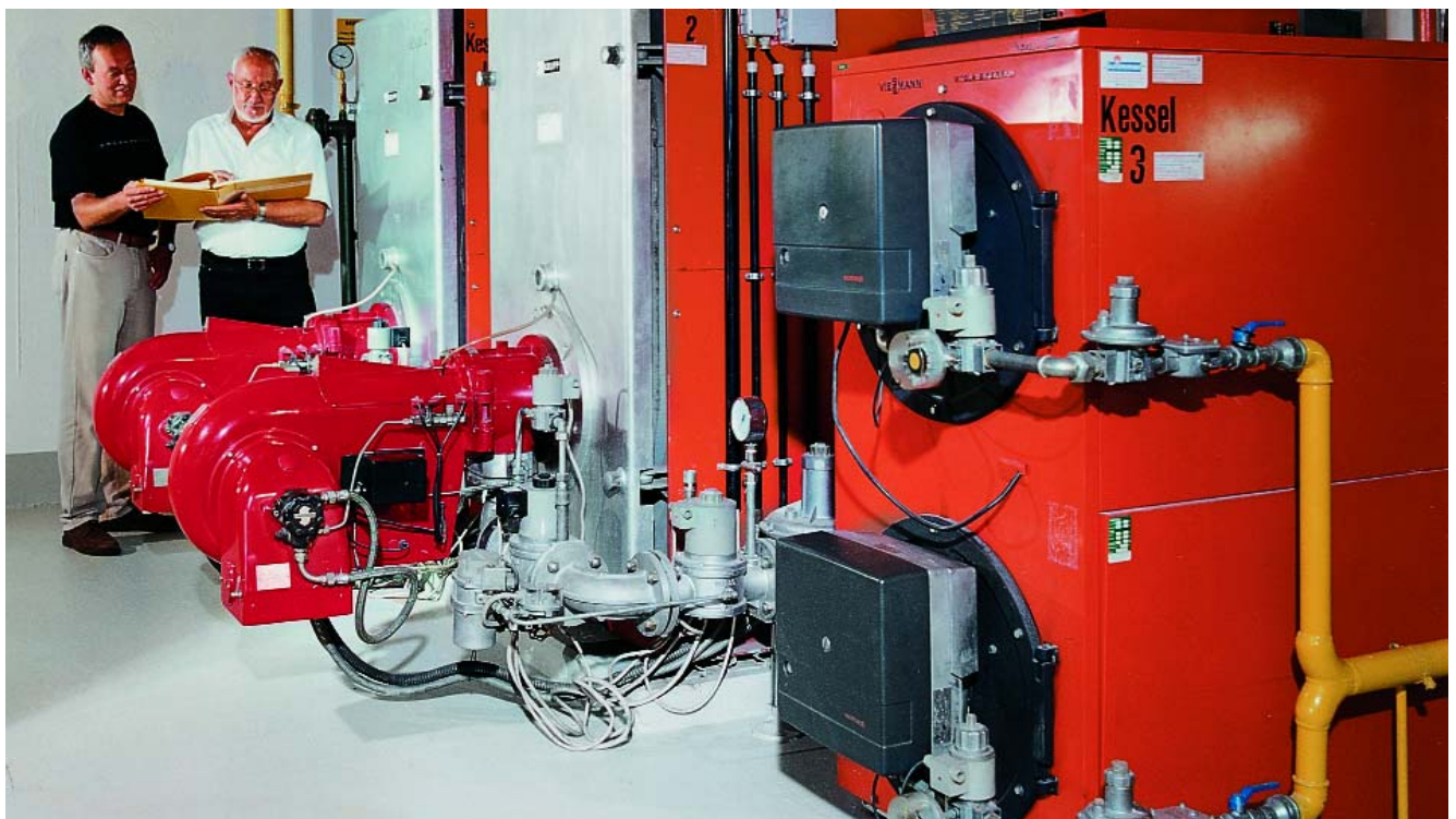
Michael Krumböck (links), Umweltbeauftragter der Stadt Leutkirch, und Manfred Nübel, 2003 altershalber ausgeschiedener Leiter der Weishaupt-Niederlassung Wangen, in der Energiezentrale des Hans-Multscher-Gymnasiums. Neben moderner Gebäudeleittechnik sind dort auch Gas- und Zweistoffbrenner von Weishaupt im Einsatz
