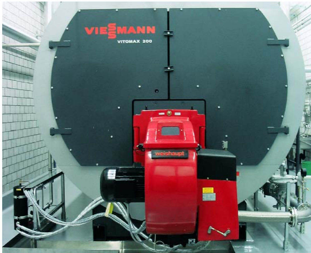
Ein Weishaupt-Zweistoffbrenner RGL70 multiflam® befeuert den Dampferzeuger Fabrikat Viessmann. Der erzeugte Dampf wird für verfahrenstechnische Prozesse wie Pasteurisieren oder Sterilisieren benötigt
