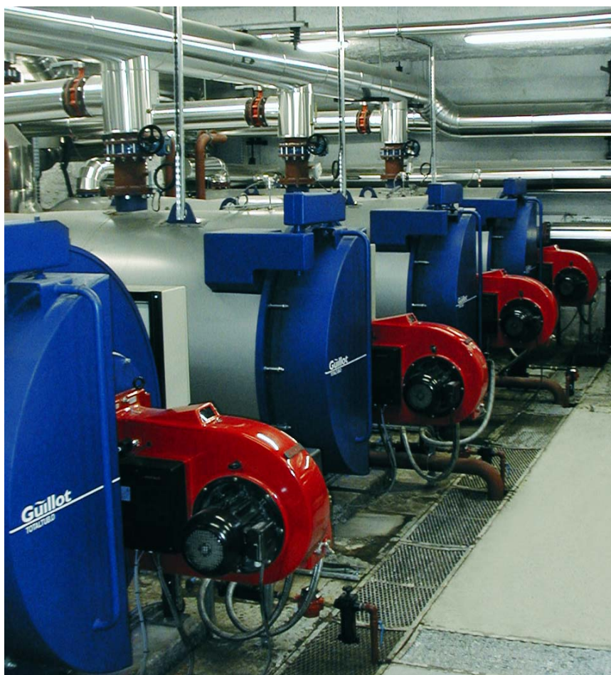
In der modernisierten Heizzentrale des Ortskerns "La Croisette" arbeiten vier Weishaupt Ölbrenner RL50 multiflam® an den Guillot-Kesseln mit einer Wärmeleistung von 2.320 bis 2.550 kW
