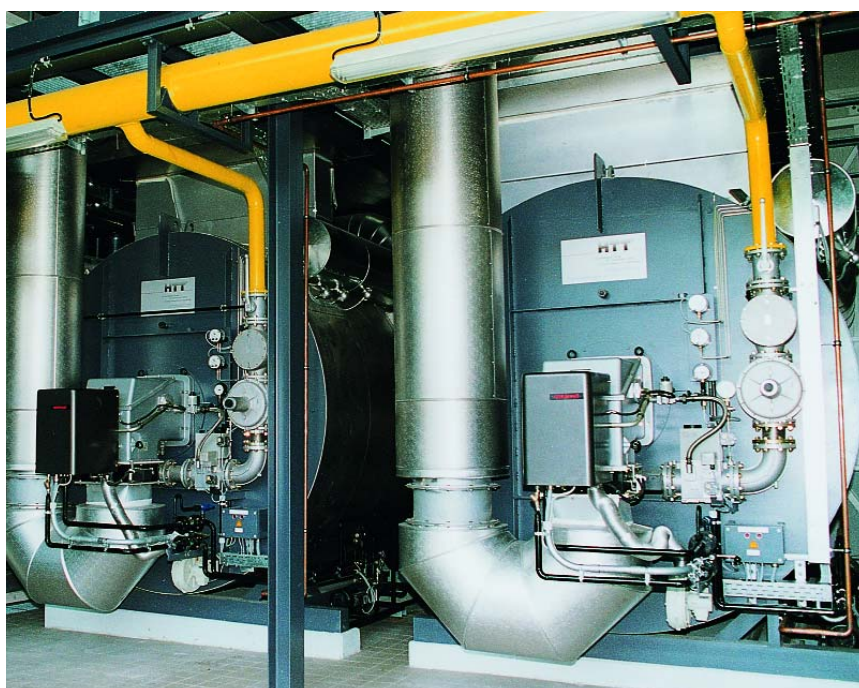
Heizzentrale einer Kalandersstraße zur Herstellung von PVC-Folien in der Pharmaindustrie. Die Wärmeerzeuger (Leistung je 4.500 kW) werden befeuert von Weishaupt-Zweistoffbrennern Typ WKGL
