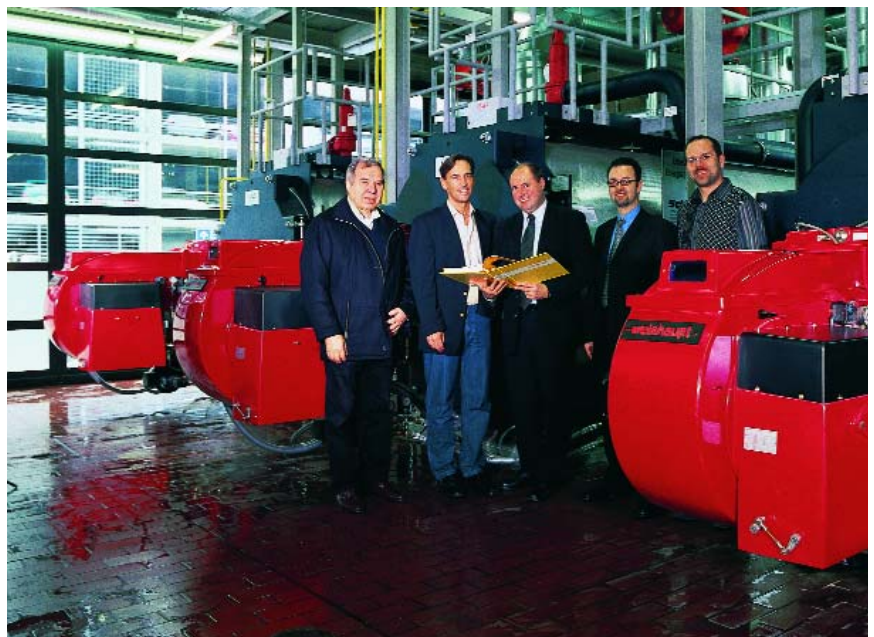
Drei Weishaupt-Zweistoffbrenner der Typen RGL70 multiflam® und RGL60 arbeiten in der neuen Energiezentrale des Nürnberger Flughafens. An der Anlage (v.l.n.r.): Friedhold Hertling (ehemaliger Leiter der Weishaupt-Niederlassung Nürnberg - 2003 altershalber ausgeschieden), Hans-Jörg Schriegel (Geschäftsführer Heizungsbau-Fachfirma Schriegel), Hans-Jürgen Grauer (Leiter Betriebstechnik Airport Nürnberg), Bernd Gerlach (Weishaupt-Niederlassungsleiter in Nürnberg) und Stefan Loskam (Projektleiter der Heizungsbau-Fachfirma Schriegel)
