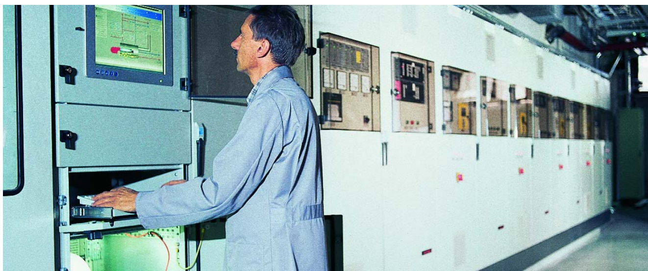
Eine Weishaupt-Schaltanlage übernimmt die gesamte Regelung und Steuerung der Energiezentrale. Die darin integrierte Neuberger-Gebäudeleittechnik ermöglicht es dem Betreiber, die Anlage fernzubedienen und fernzuwarten
