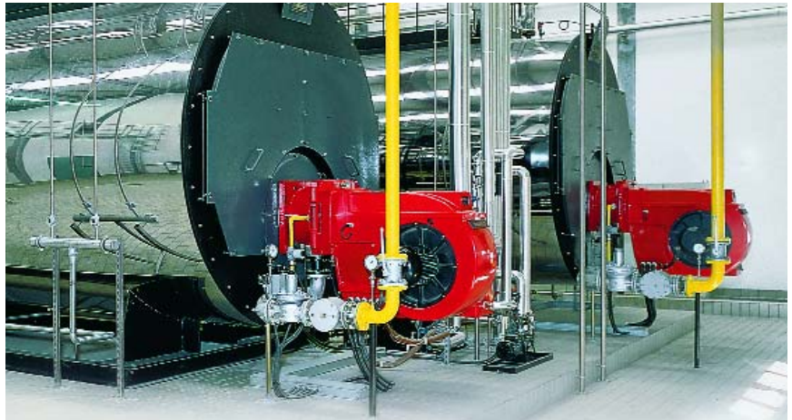
Anlage mit Mehrkesselregelung System Weishaupt
