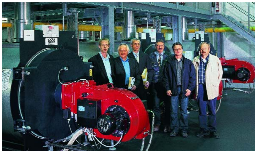
In der neuen Heizzentrale der Jungheinrich Moosburg GmbH (v.l.n.r.): Holger Göbels (Geschäftsführer Ing.-Büro Technoplan), Rudolf Spanner (Produktionsleiter der Jungheinrich Moosburg GmbH), Wolfgang Kühn (Niederlassungsleiter Weishaupt München), Kurt Schiewitz (Geschäftsführer Ing.-Büro Technoplan), Rainer Volke (Bau- und Energiewesen bei Jungheinrich) und Ludwig Hommer (Gruppenleiter Industrie der Heizungsbaufirma Enderes GmbH)
