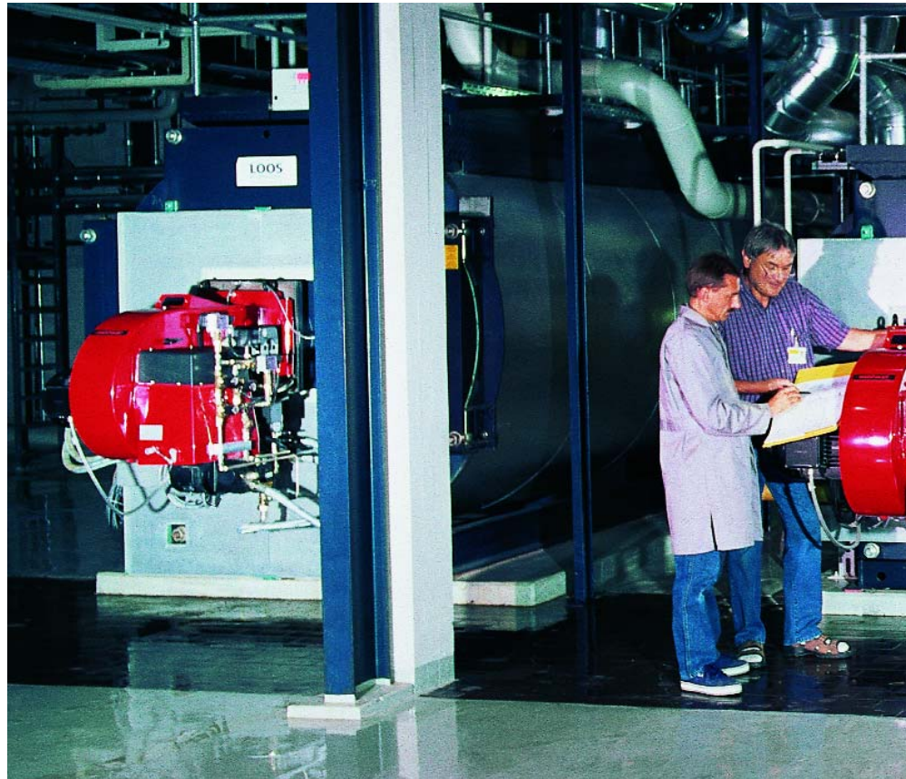
Drei der insgesamt vier Weishaupt Gas-, Öl- und Zweistoffbrenner in der modernisierten Energiezentrale des Böblinger die für die gesamte Gebäudetechnik zuständig ist
