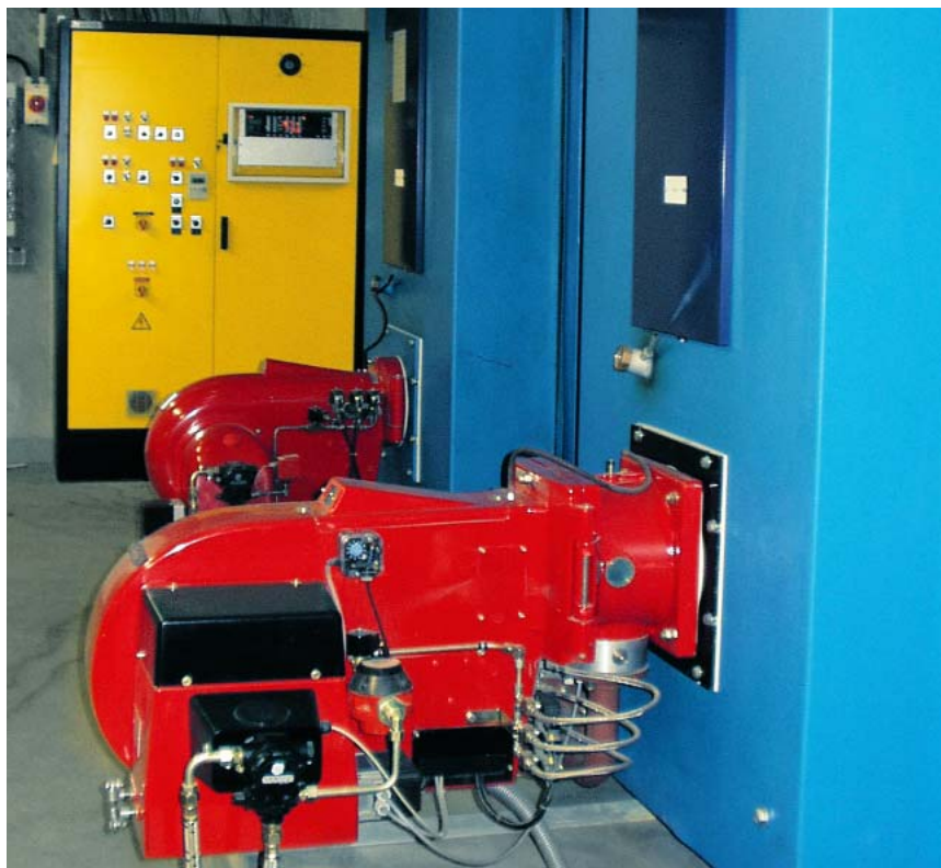
Drei Weishaupt Öl- bzw. Zweistoffbrenner der Typen GL30, GL8 und L7 sowie eine Weishaupt-Schaltanlage mit Neuberger-Gebäudeleittechnik gewährleisten die Wärmeversorgung für das Westfalenstadion und dessen Rasenheizung
