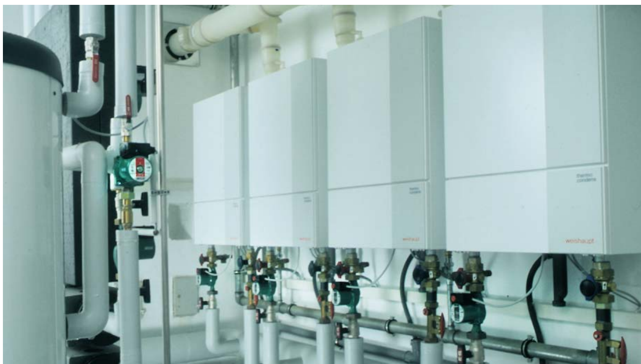
Eine 240 kW-Kaskade mit vier Gas-Brennwertgeräten Weishaupt Thermo Condens WTC60 in Verbindung mit dem Wasserpumpe Weishaupt Aqua Standard WAS 280 versorgt die Firma Oelze mit Wärme
