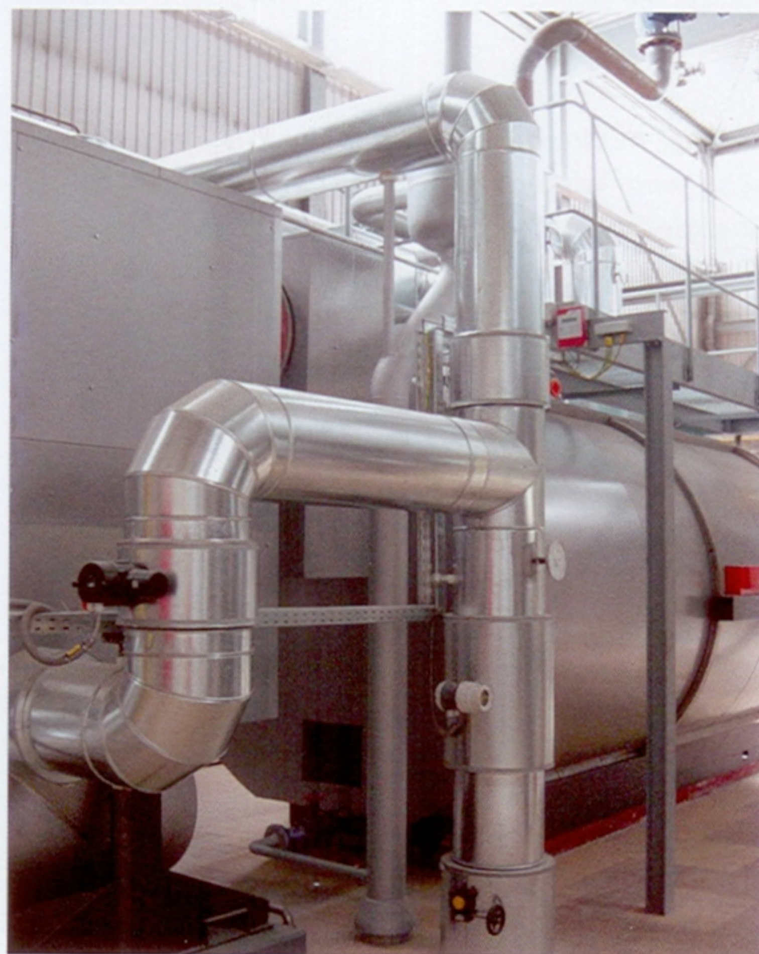
Im Unternehmen KWS Biotechnikum in Einbeck wurde der Wärmeversorger erneuert und in das bestehende System eingebunden. Die Heizwärmeleistung der Kesselanlage beträgt 4.500 kW und nutzt die Abgaswärme.
