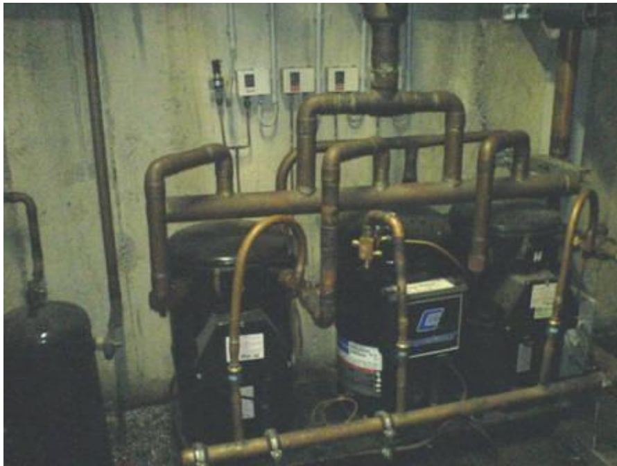
Scrollverdichter R401a Kaltwassererzeugung Kälteleistung 3 x 40 kW
