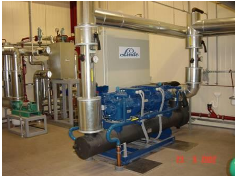
Schraubenverdichter R410a Kälteleistung 2 x 170 kW
