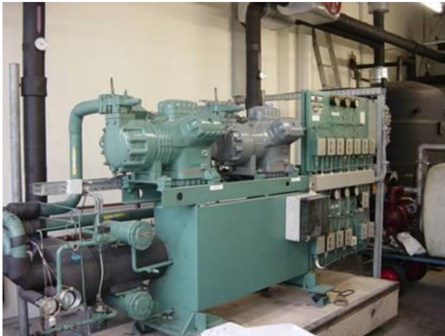
Kolbenverdichter 2 halbhermetische R22 Kälteleistung 2 x 130 kW
