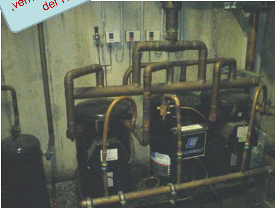
Scrollverdichter R401a Kaltwassererzeugung Kälteleistung 3 x 40 kW
