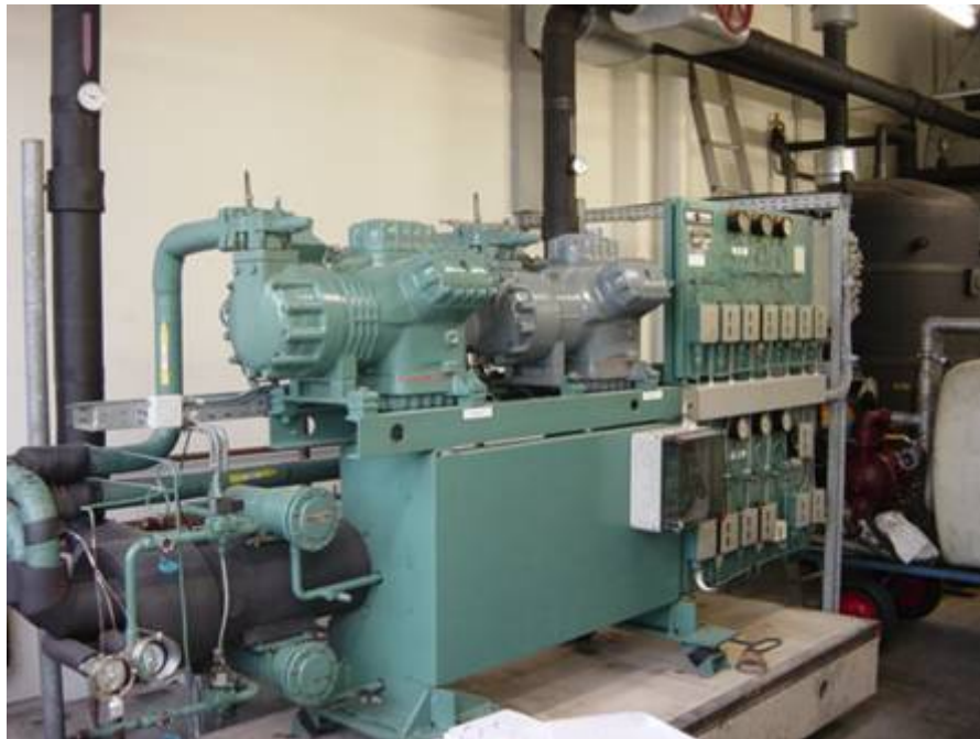
Kolbenverdichter 2 halbhermetische R22 Kälteleistung 2 x 130 kW
