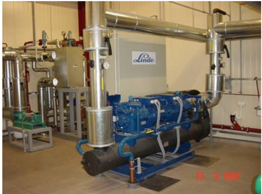
Schraubenverdichter R410a Kälteleistung 2 x 170 kW
