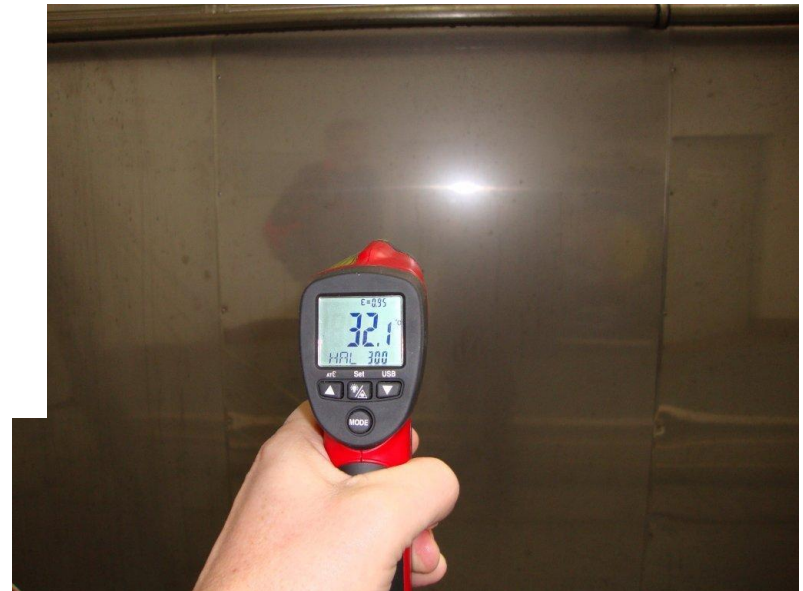
Reduzierte Oberflächentemperaturen nach nachträglicher Zusatzisolierung
